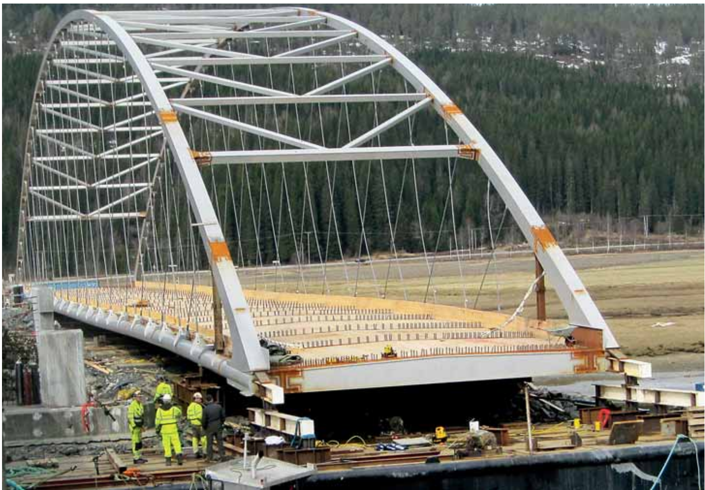
Her ser vi buen med vindfagverket og strekkbåndet som møtes i et knutepunkt sammen med endetverrbæreren. Brua er her på vei over elva. Den ligger på en lekter på nærmeste akse og to vogner på den andre akse. Bak knutepunktene ser vi trykkstavene som er montert inn under flyttinga for å stabilisere buen. Vi ser at strekkbåndet ikke har riktig geometri på grunn av eksentrisk opplegg under lansering.
